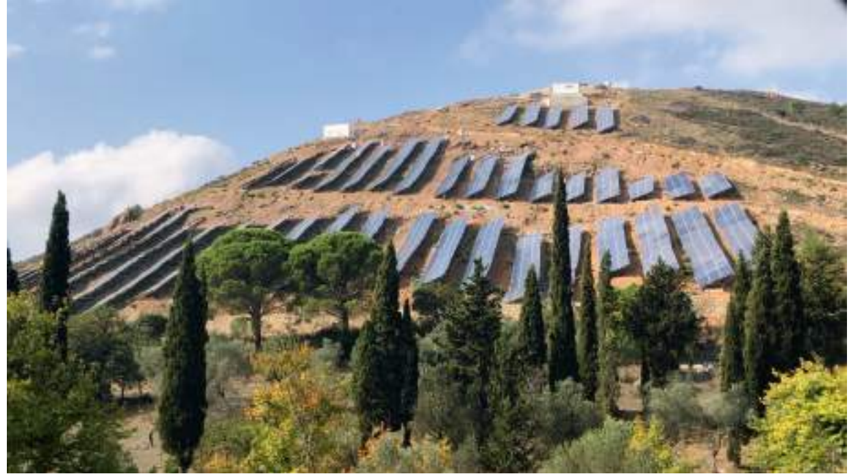
COŞAR GES / DURUSU GES 2180 kWp, 2017 Dereköy / BODRUM
