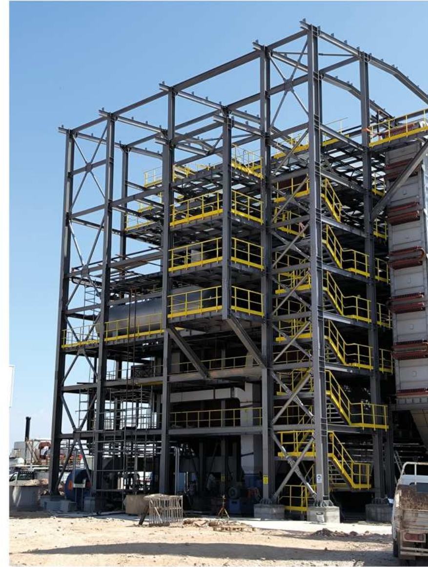
5ER ЭНЕРГИЯ / ТЕТА КОТЕЛ ЧУМРА - КОНЬЯ ЭЛЕКТРОСТАНЦИЯ НА БИОМАССЕ 400 ТОНН
