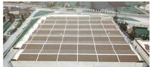
TRABZON ATEŞLER ORMAN ÜRÜNLERİ 414,96 KWP 330 KWE
