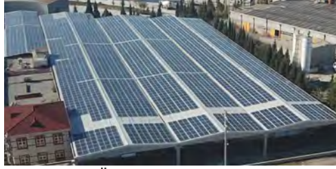
GÜVEN VE MUDO GES 2.2MWp / KAHRAMANMARAŞ / 2017
