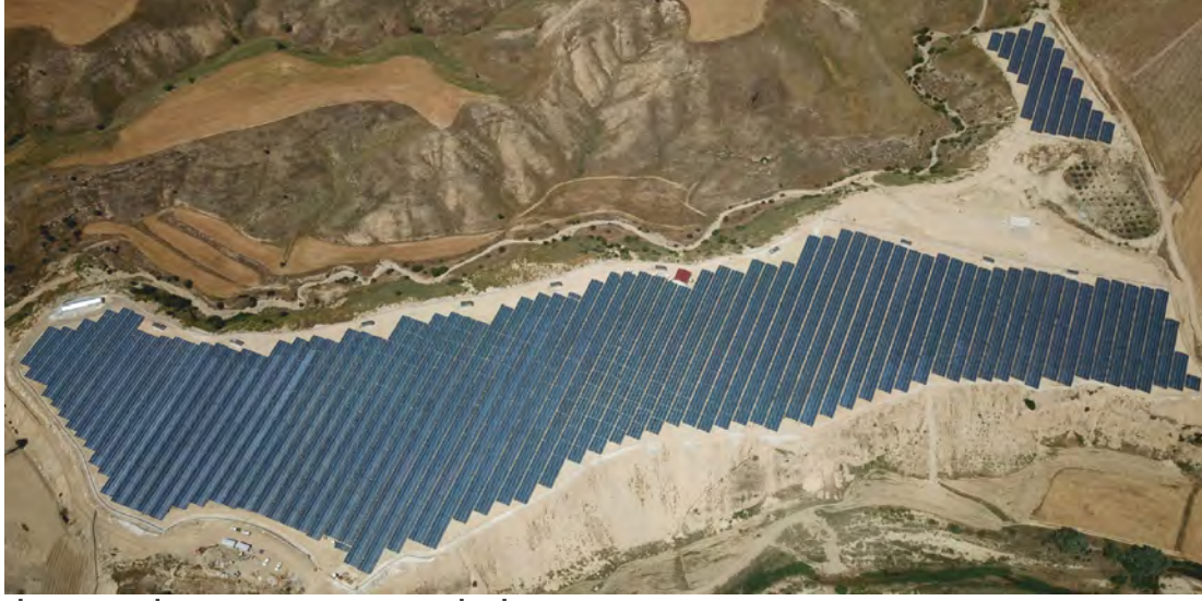
FİNA ENERJİ A.Ş. / 10.7MWp / DENİZLİ OSB / 2017
