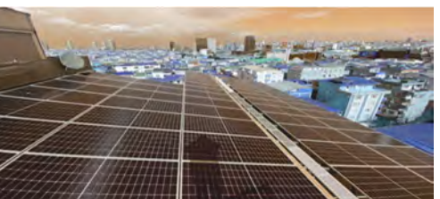
MOTOR AŞIN GES/160kWe /150kWh İSTANBUL / 2024
